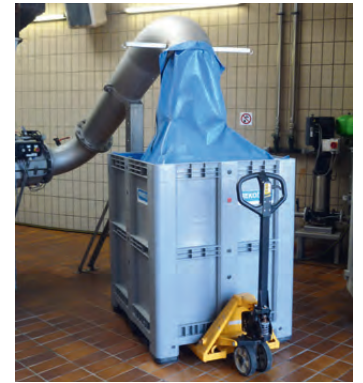
Rechengutabfüllung – Umsetzen mit Hubwagen, Ameise, Stapler
